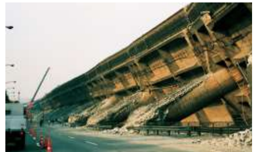
倒壊した高速道路 阪神高速道路(株) 提供
