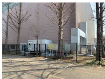
屋内運動場屋外機
