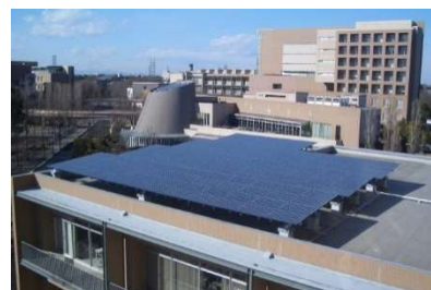
留学生日本語教育研究センター屋上 太陽光発電設備
