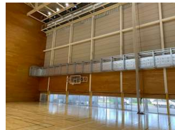
屋内運動場アリーナ 空調ダクト
