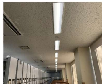
附属図書館照明LED化
