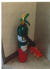
消火設備(名大)
