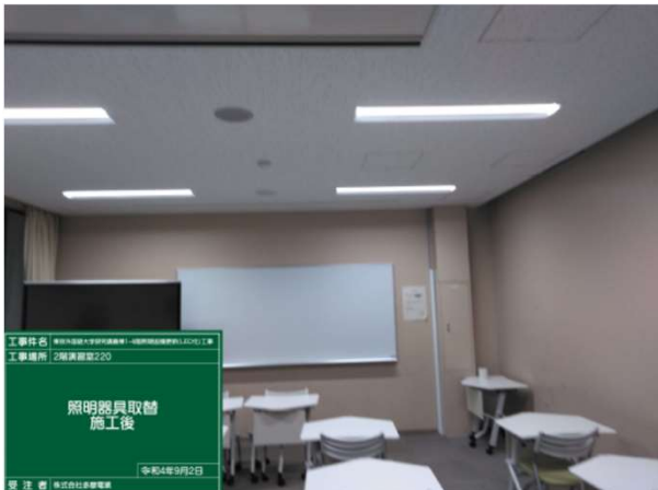
研究講義棟照明LED化(演習室220)
