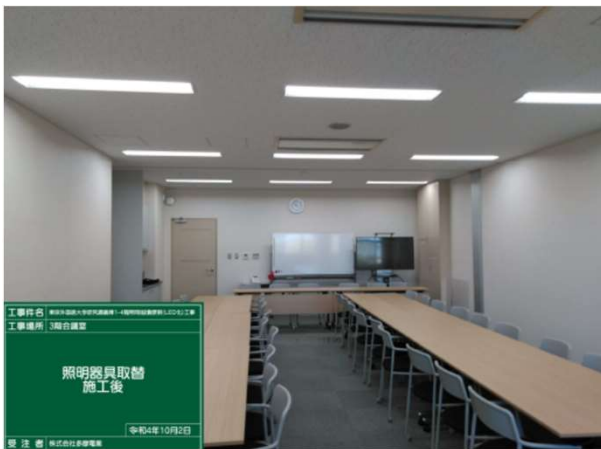
研究講義棟照明LED化(3階会議室)
