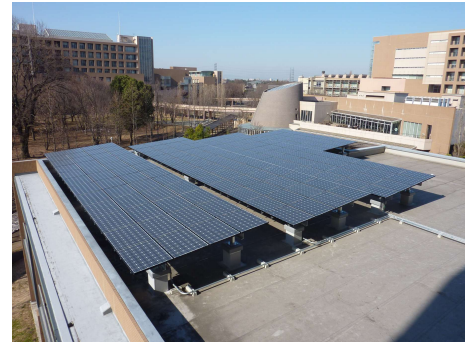
留日センター棟屋上太陽光発電設備
