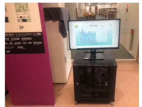
附属図書館太陽光発電モニター
